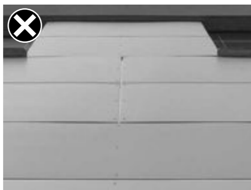
Расстояние между опорами слишком велико Неправильный монтаж панелей Tempsi (превышение допустимого расстояния между опорами или шурупами) вызывает деформацию, что может привести к разрушению панелей.
